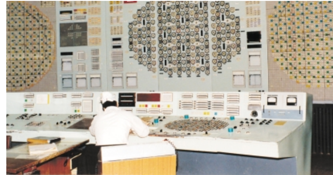
Leningradin ydinvoimalaitoksen kolmosyksikön valvomo vuonna 1992.
