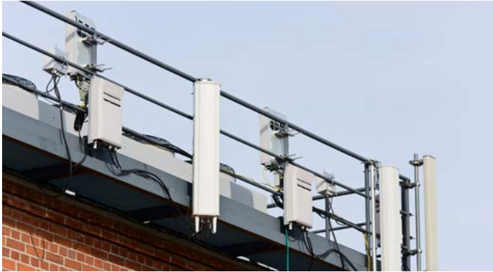
Kuva 2. Katolle asennettuja tukiaseman lähettämiä ja antenniä.
