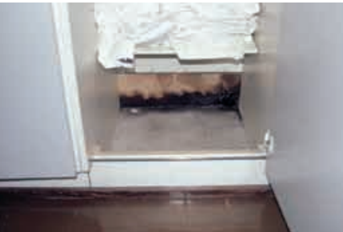
Vaurio kaapin takaseinässä.
