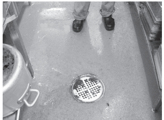
Kuva 9.2. Lattioiden kaadot ja lattia-kaivojen paikat tuntuvat usein olevan kompastuskivi esimerkiksi keittiötilojen järjestelyssä.
