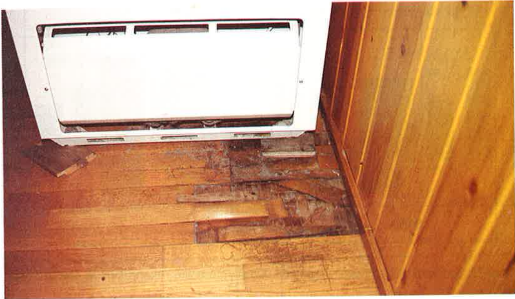
Kuva 15. Pakastimen aiheuttama kosteusvaurio parkettilattiassa.
