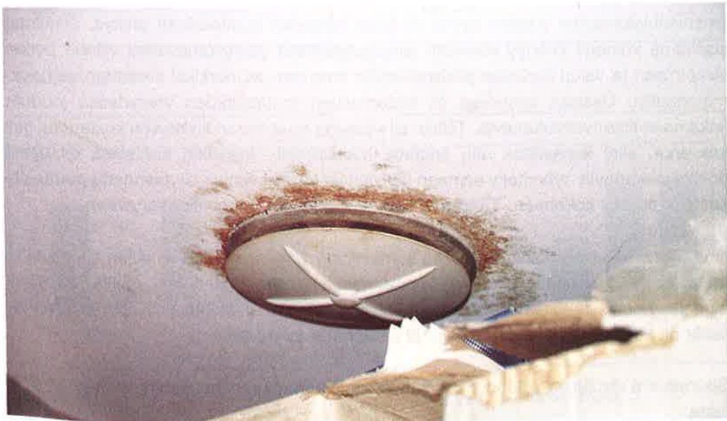
Kuva 16. Ilmanvaihtokanavan vuodon aiheuttama kosteusvaurio sisäkaton verhouksessa.
