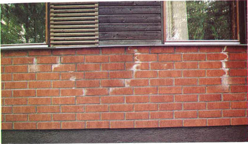
Kuva 10. Sisäänpäin kallistetun ikkunapellityksen aiheuttama kosteusvaurio ulkoseinärakenteessa.
