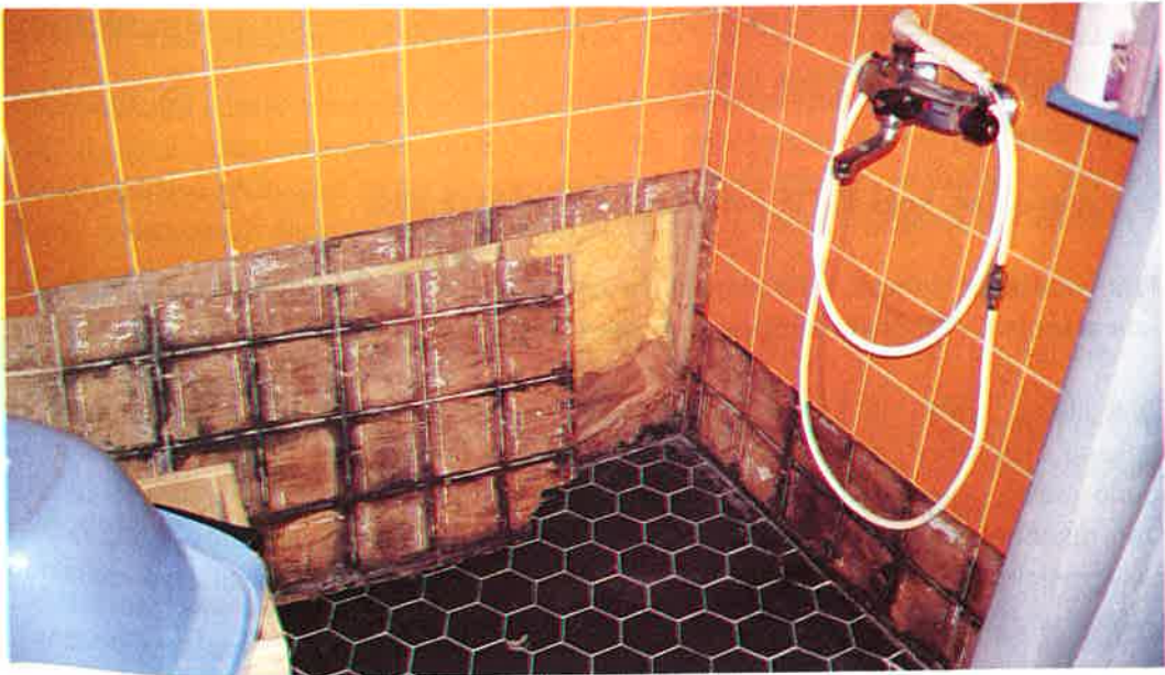
Kuva 11. Pesuhuoneen seinälaitoituksen taustarakenteen kosteusvaurio.
